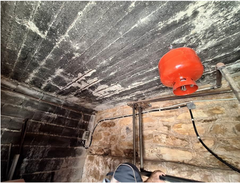
Άποψη του εσωτερικού του λεβητοστασίου
