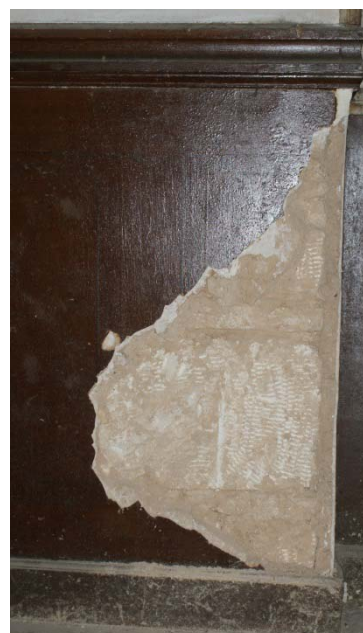
Εικόνα 52. Απώλεια κονιάματος στον χώρο Β.3.
