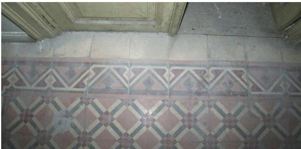
Εικόνα 172. Ισόγεια στάθμη – Χώρος ΙΣ.6, λεπτομέρεια λανθασμένης επανατοποθέτησης των πλακιδίων.
