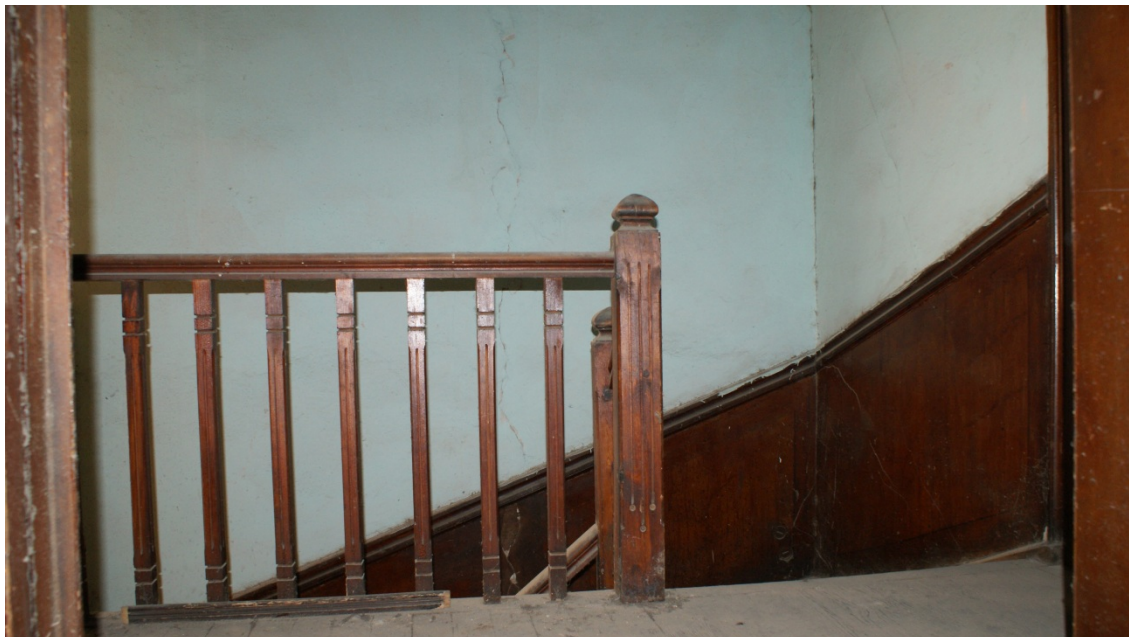
Εικόνα 45. Ρωγμές στους τοίχους του κλιμακοστασίου του α' ορόφου.
