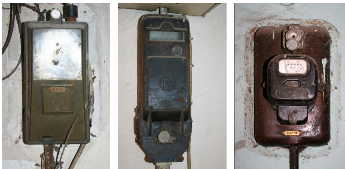
Εικόνα 183,184,185. Η ανώτερη συσκευή μέτρησης του ηλεκτρικού ρεύματος στους χώρους ΙΣ.1, ΙΣ.3 και ΙΣ.5 αντίστοιχα.
