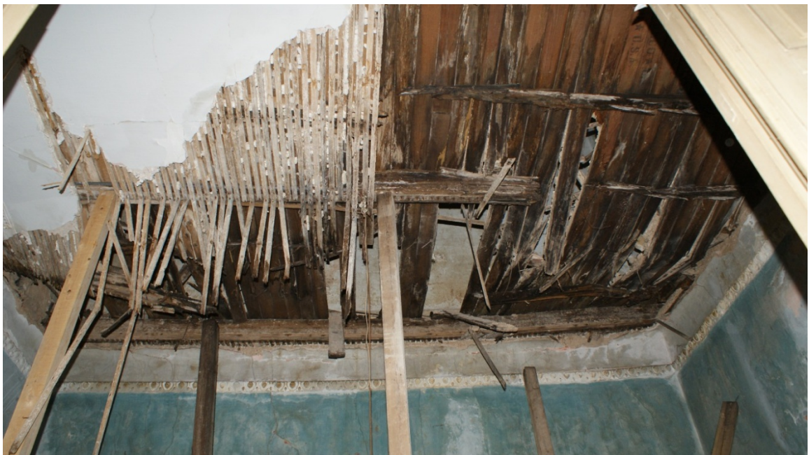
Εικόνα 32. Κατάρρευση οροφής του χώρου ΙΣ.8.
