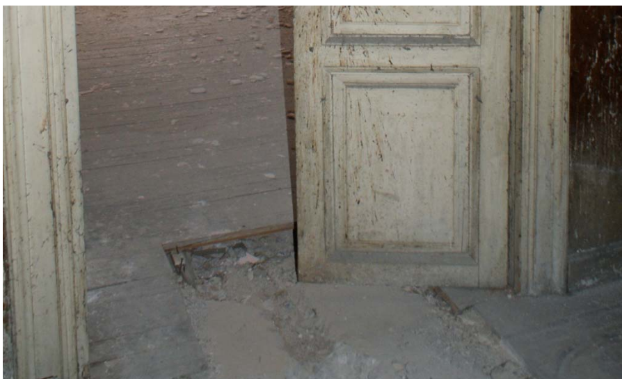
Εικόνα 97. Απώλειες τμημάτων ξύλινου δαπέδου.
