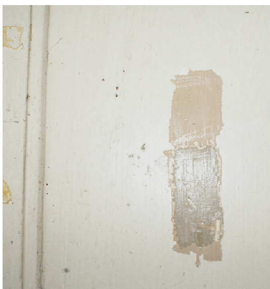
Εικόνα 92. Διερευνητική τομή σε εσωτερική ξύλινη θύρα λευκού χρώματος.
