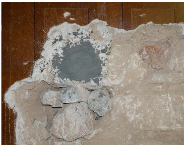
Εικόνα 36. Απώλεια κονιάματος στην περιοχή της διαχωριστικής επιφάνειας στον χώρο Α.2.
