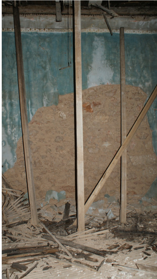
Εικόνα 31. Φθορές του χώρου ΙΣ.8.
