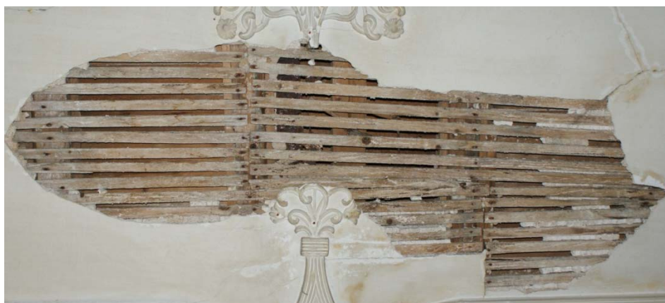
Εικόνα 13. Άποψη φθοράς στην οροφή του α' ορόφου όπου γίνεται αντιληπτή η τεχνική κατασκευής με τη μέθοδο του μπαγδατί.
