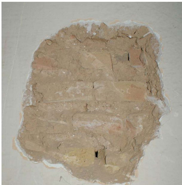
Εικόνα 28. Ολική απώλεια υποστρώματος ζωγραφικής επιφάνειας στον χώρο ΙΣ.6
