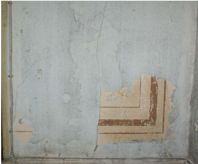
Εικόνα 47. Φθορές που εντοπίζονται στο χώρο Α.8.
