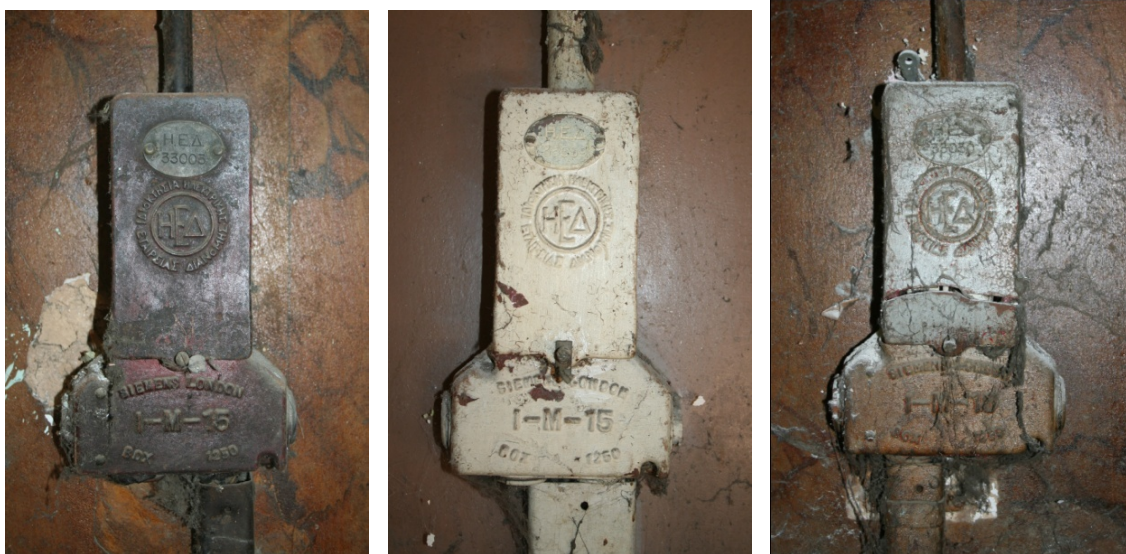
Εικόνα 180,181,182. Η κατώτερη συσκευή μέτρησης του ηλεκτρικού ρεύματος στους χώρους ΙΣ.1, ΙΣ.3 και ΙΣ.5 αντίστοιχα.
