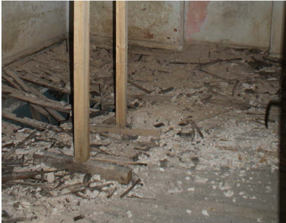
Εικόνα 98. Ολοσχερής καταστροφή του ξύλινου δαπέδου του Χώρου Α.7.
