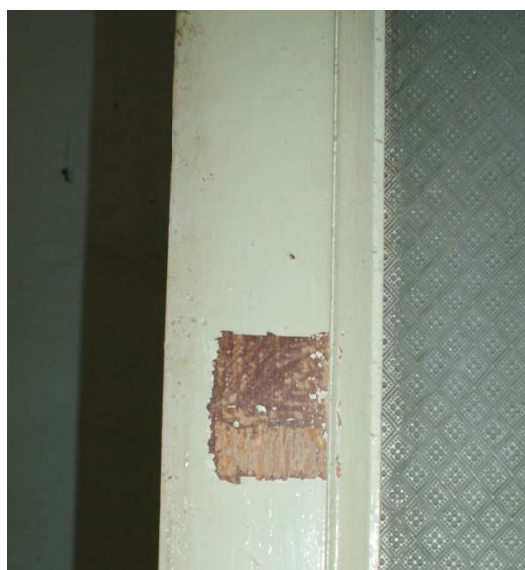
Εικόνα 93. Διερευνητική τομή σε εσωτερική ξύλινη θύρα λευκού χρώματος.
