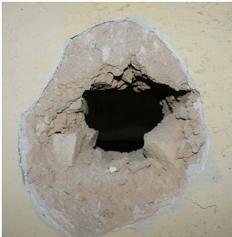
Εικόνα 42. Απώλεια του υποστηρίγματος στον χώρο Α.5.
