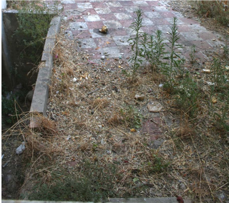
Εικόνα 169. Αυτοφυής βλάστηση ανάμεσα στα πλακίδια του αύλειου χώρου.
