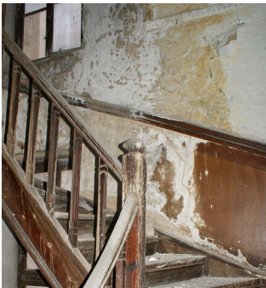
Εικόνα 557. Άποψη κλιμακοστασίου Κλ.1 με έντονες φθορές στους περιμετρικούς τοίχους.
