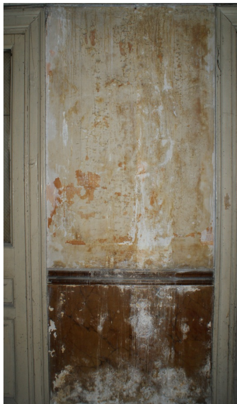
Εικόνα 59. Εκτεταμένες φθορές σε τμήμα του χώρου Β.5.
