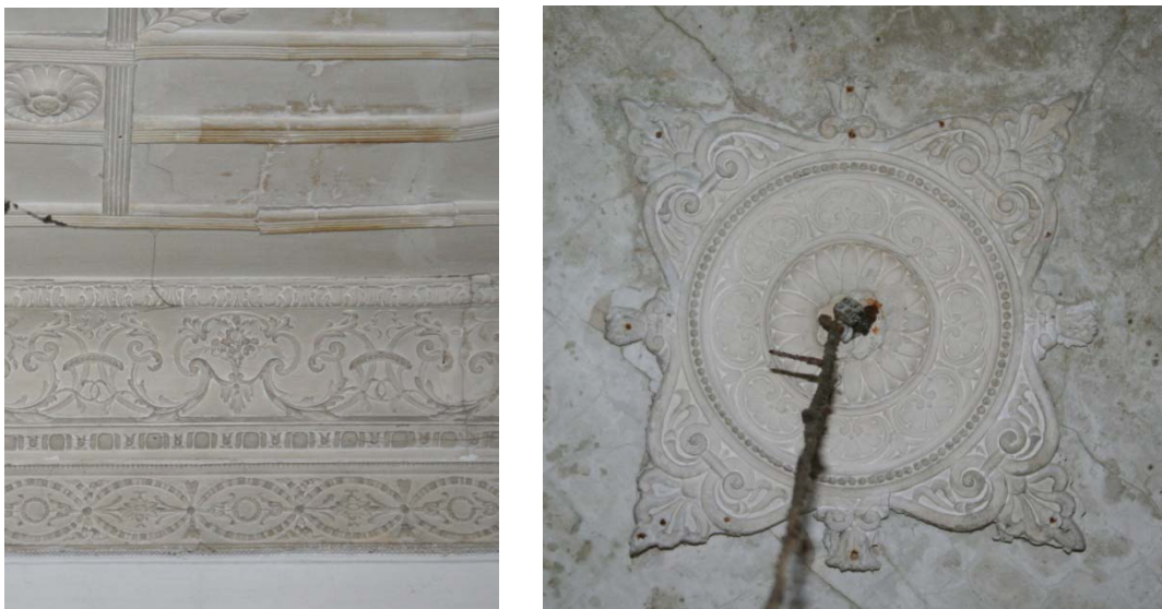
Εικόνες 133,134. Επικίνδυνη αποκόλληση τμημάτων.
